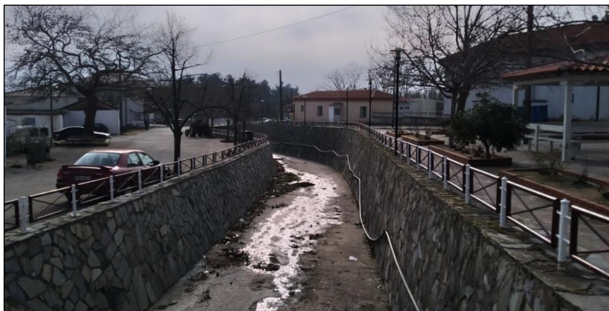
Εικόνα Α4.31: Αντιπλημμυρική προστασία στον οικισμό Μίσχου (πηγή: ίδια λήψη)
