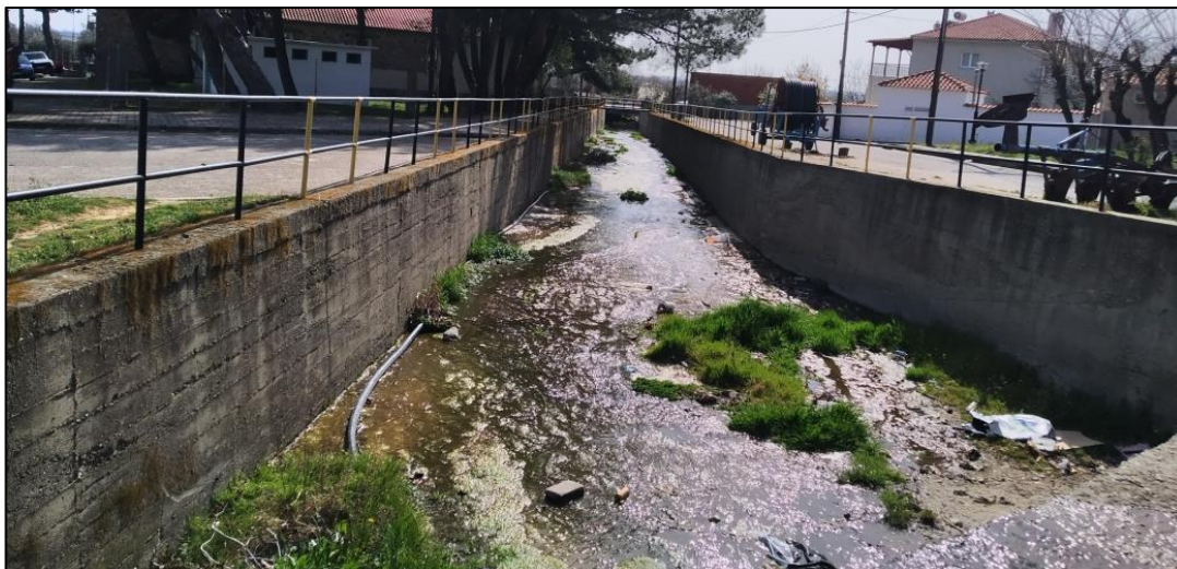
Εικόνα Α4.32: Αντιπλημμυρική προστασία στον οικισμό Πολύανθου (πηγή: Ίδια λήψη)
